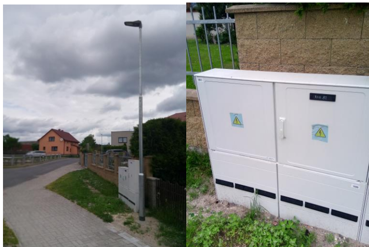
Obrázek 3: Celkový pohled a detail rozvaděče
