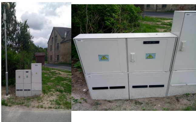
Obrázek 1: Celkový pohled a detail rozvaděče
